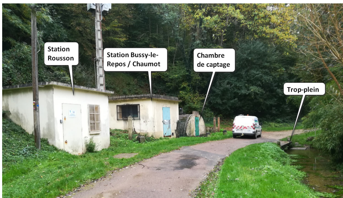
Figure 12 : captage de la source de la Fontaine Rouge.
