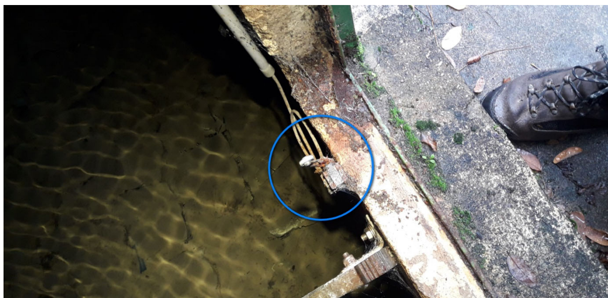
Figure 29 : contacteur bassin de collecte.
